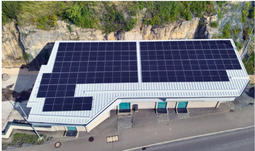
Luftbild des Tunnel-Betriebsgebäudes mit den neuen PV-Modulen
