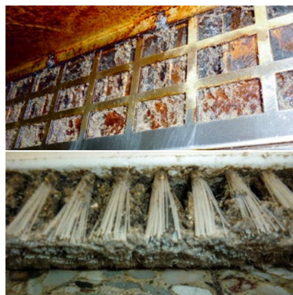
Stark verunreinigtes Lüftungsgitter am Backofen und stark verunreinigter Besen
