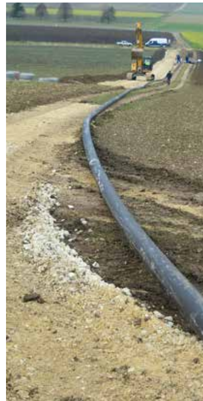
Bau der Sickerwasserleitung und des Filterbeckens auf der Deponie „Roter Hau“ bei Ehingen.
