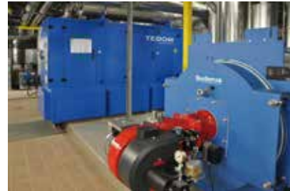
Das neue Blockheizkraftwerk im Gesundheitszentrum Blaubeuren.
