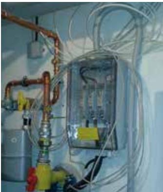
Anschluss technik für IT-Arbeitsplätze in einer Gemeinschaftsunterkunft.
