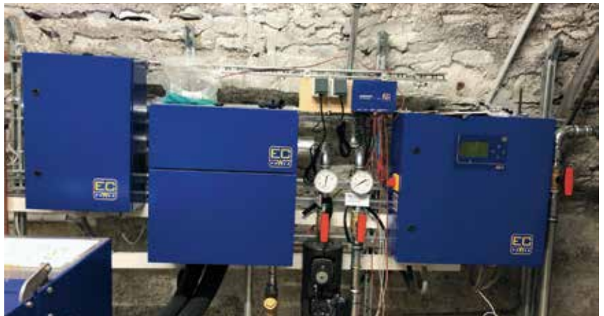
Das neue Blockheizkraftwerk für die Landratsamts-Außenstelle im Ritterhaus in Ehingen.
