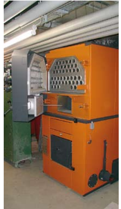
Holzhackschnitzel-Anlage im Berufschulzentrum in Ehingen
