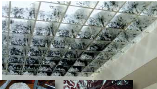
Schimmelbefall an der Decke.
