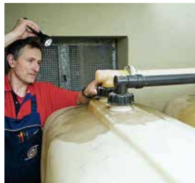
Leckage an der Füll- und Entlüftungsleitung – Fachmann überprüft die Sicherheit und Technik.
