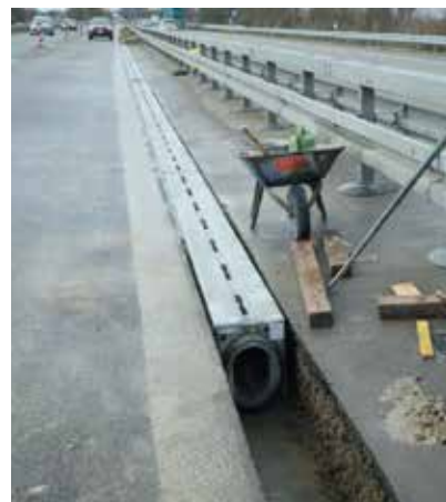
Funktionierende Straßenentwässerung: eine wichtige Aufgabe für den Straßenunterhalt.
