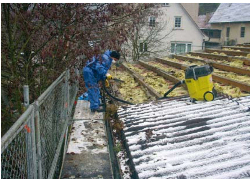
Asbest! Dachsanierung ist nötig.
