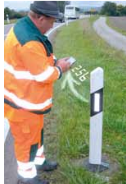
Verkehrszählgeräte werden an Leitpfosten montiert.
