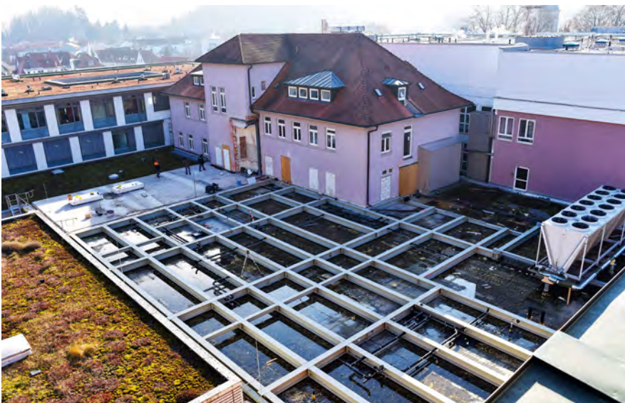
Stahlträgerkonstruktion auf dem Dach des Klinikgebäudes in Blaubeuren für die neue Intensivstation.
