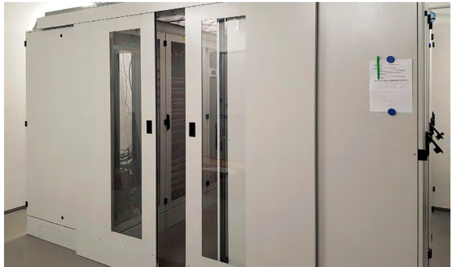
Beim neuen Rechenzentrum des Landratsamts, im neuen „Gebäude B“ der Kreisverwaltung in Ulm.
