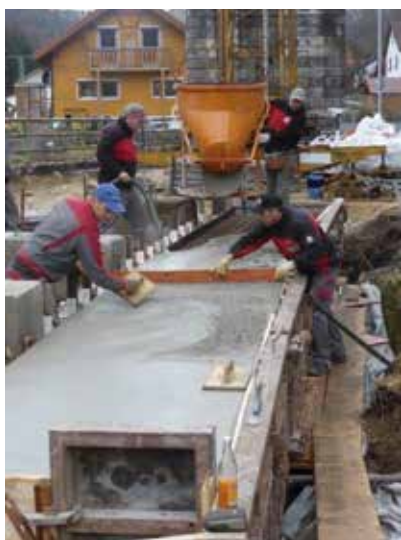
In diesem Hohlraum („Fledermausbalken“) unter der neuen Brücke finden Wasserfledermäuse ein neues Quartier.
