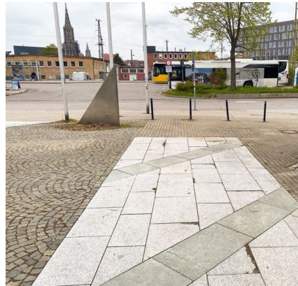
Schäden am bisherige Vorplatz
