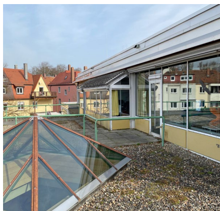
Das schadhafte Flachdach der Valkenburgschule
