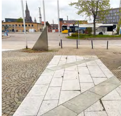
Schäden am bisherige Vorplatz
