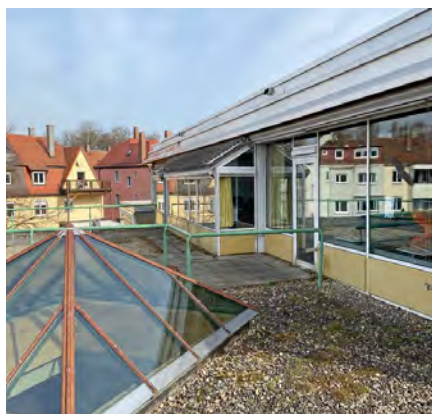
Das schadhafte Flachdach der Valkenburgschule
