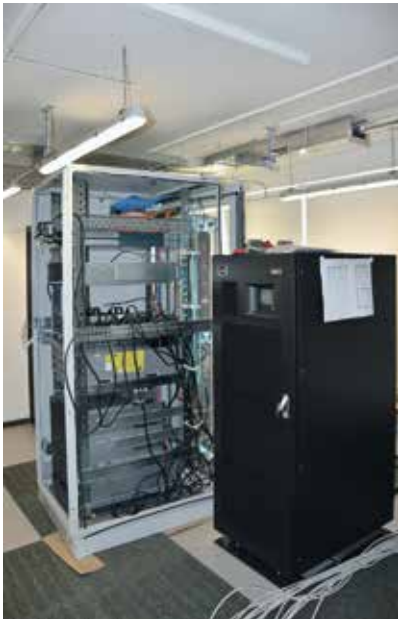
Serverschrank und neue USV-Anlage
